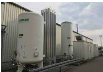
Stickstoffgenerator (70 m 3 /h)
