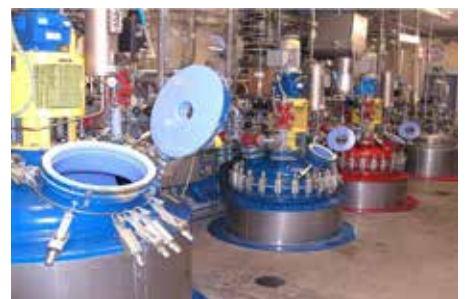
Technikumsanlage in Dieburg
