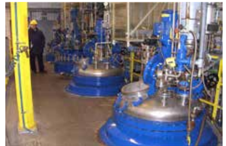
Technikumsanlage in Dieburg
